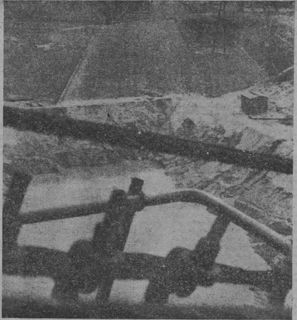
Dół ten wykopała w ciągu dwu tygodni jedna koparka, wykonująca pracę 600 robotników. Równocześnie maszyna odrzuciła wybraną ziemię na odległość 75 m.
