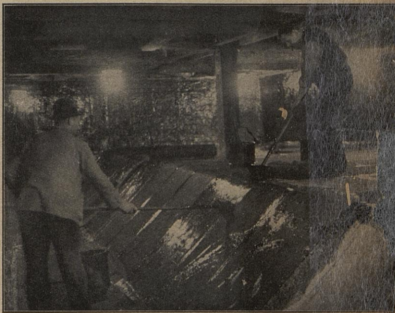
Drei Stockwerke unter dem Pflaster von Berlin wird die Grundplatte des Tunnels der neuen dreigleisigen Eisenbahnlinie gegen das Grundwasser abgedichtet.
