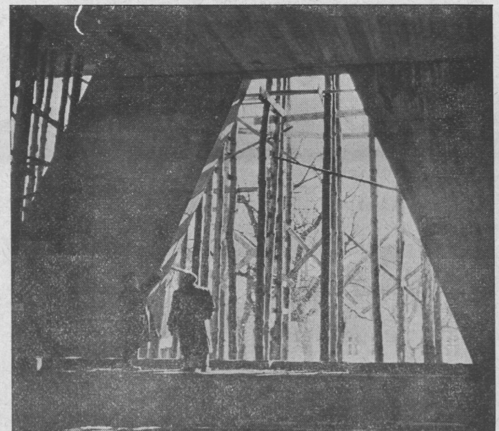
A Kotobrzeg un nouvel hôtel de quelque 200 chambres actuellement en construction (notre photo) est un des nombreux investissements qui rendront à la ville, presque entièrement détruite par la guerre, son lustre de grande station balnéaire
