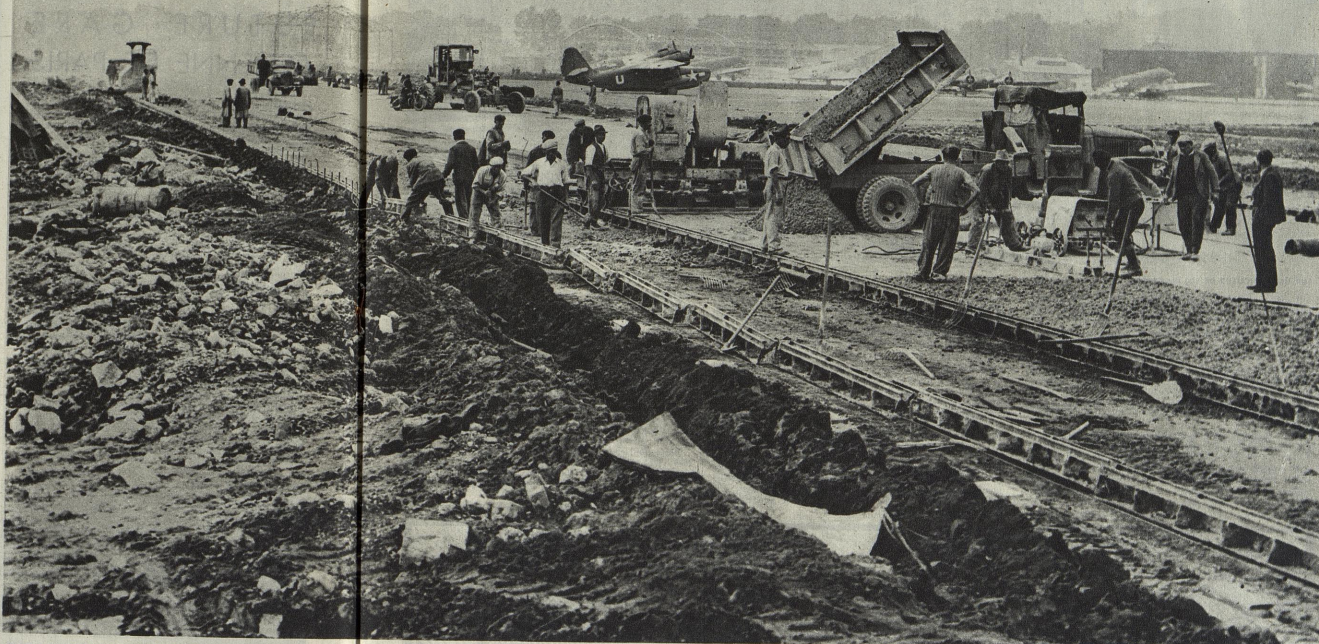
TROIS A QUATRE MILLE OUVRIERS TRAVAILLENT DEPUIS UN AN SUR L'AERODROME D'ORLY. IL FAUDRA ENCORE QUATRE ANS AVANT DE VOIR LE PROJET REALISE. DES PISTES DE PLUS DE TROIS KILOMETRES SERONT CONSTRUITES SUIVANT LES METHODES LES PLUS MODERNES.
