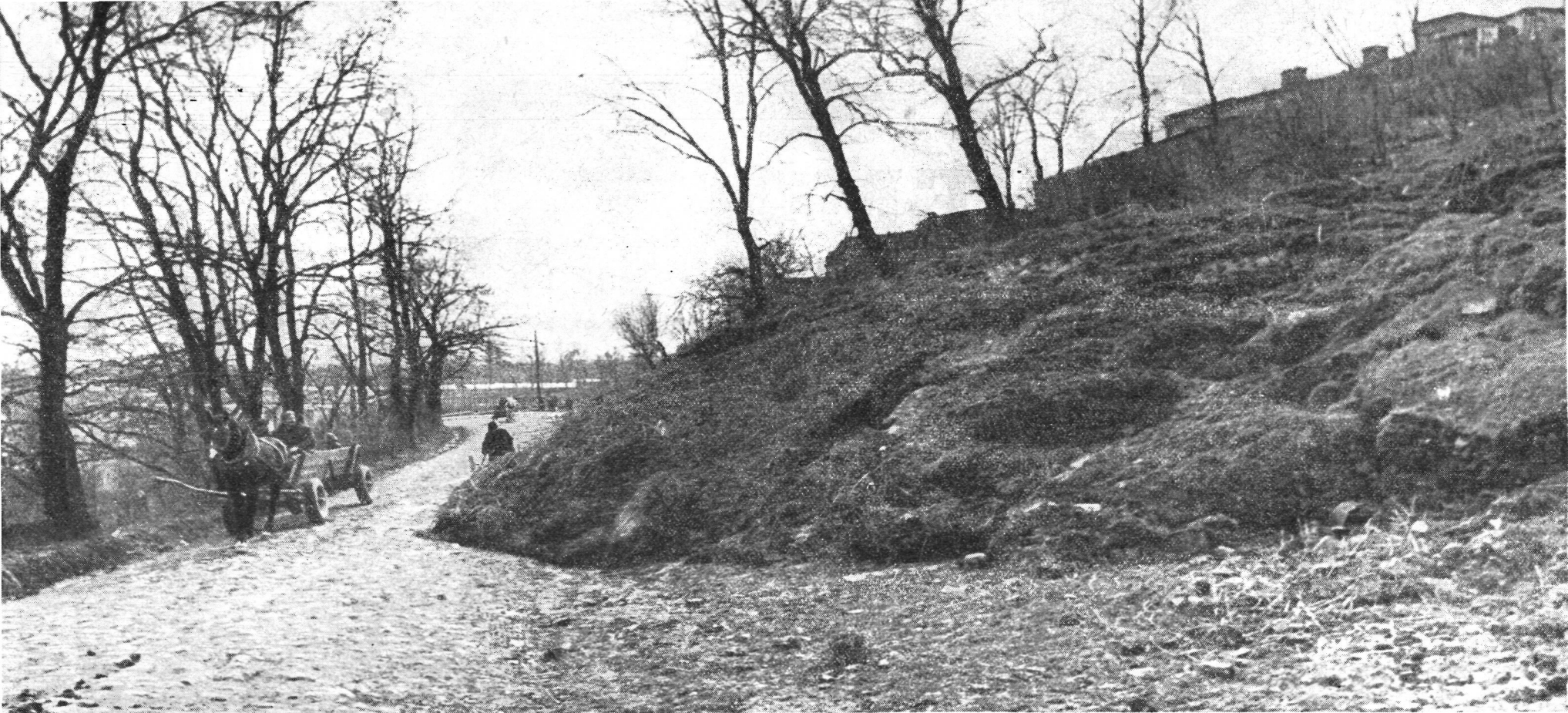
150-metrowy odcinek wysokiej skarpy, porośniętej drzewami i krzewami runął nagle w dół, odsłaniając fundamenty budynków, które znalazły się nad przepaścią
