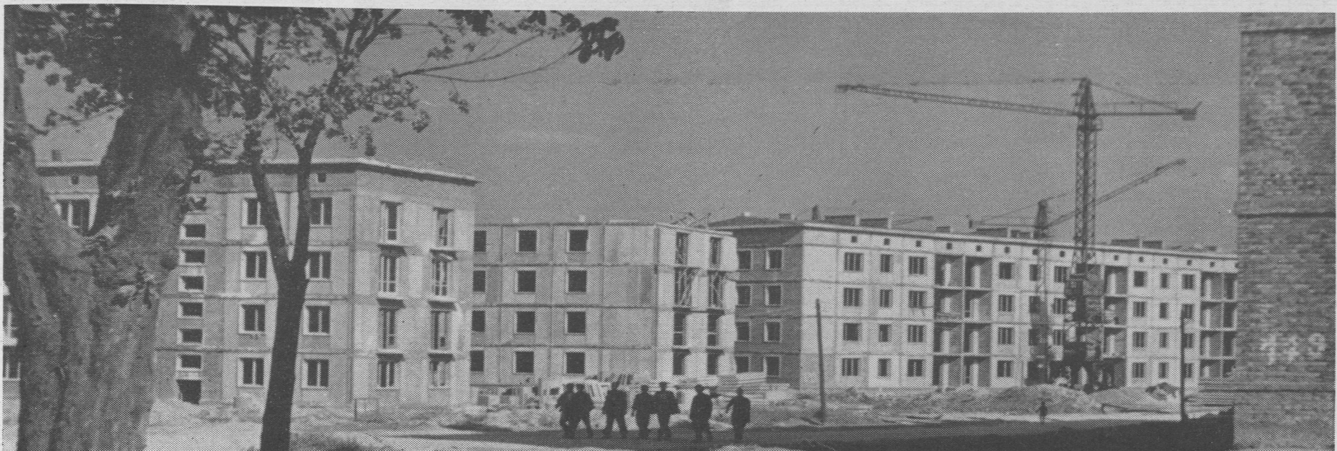
W Nowych Tychach powstanie coraz więcej nowych bloków mieszkalnych. Oto nowe osiedle w budowie.
