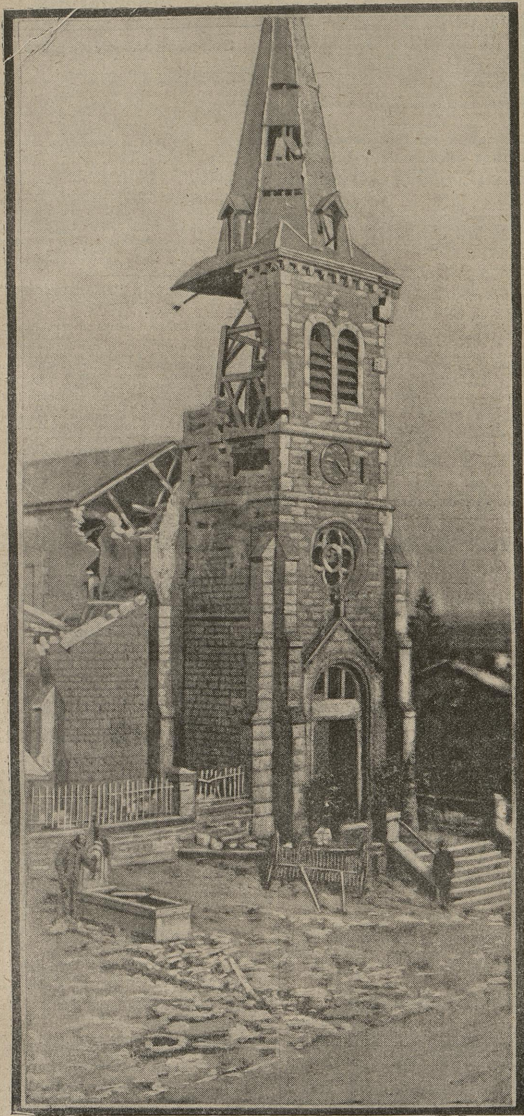
Il semble que les clochers d'églises exercent toujours une irrésistible attraction sur les obus allemands. Témoin encore celui de la petite église de Forges, que les « marmites » teutoniques ont éventré.
