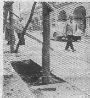
Mgr Faber przechodząc ulicą zapadł się pod ziemię, w chodniku powstała wielka wyrwa
