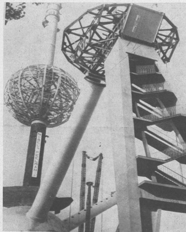
Bruksela przygotowuje się gorączkowo do Wielkiej Międzynarodowej Wystawy, której otwarcie nastąpi z początkiem 1958 roku. Na zdjęciu: fragment wielkiej konstrukcji metalowej, obrazującej potęgę energii atomowej.
