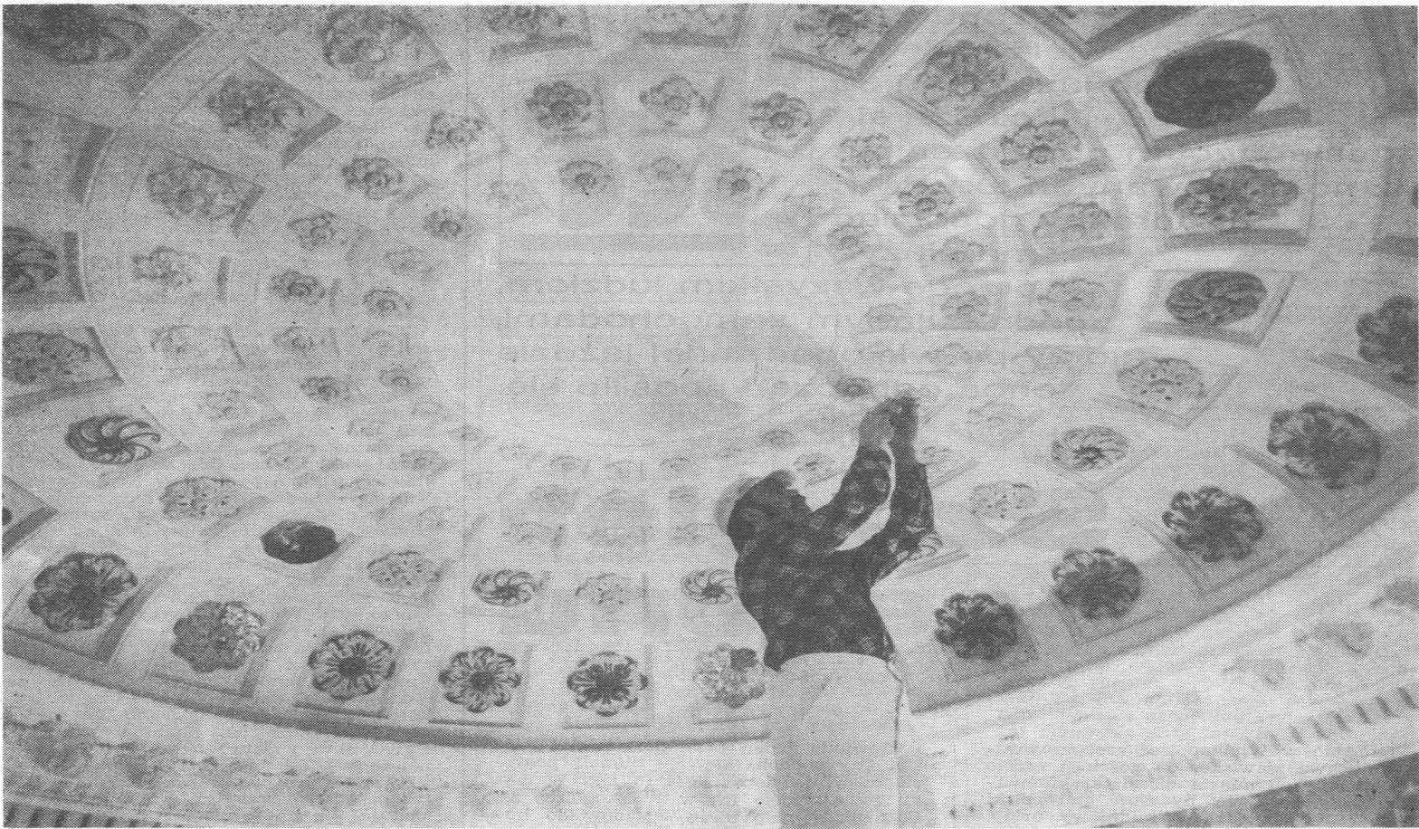
W zamkowej kaplicy trwają prace wykończeniowe. Nakłada się już złocenia na gipsowe rozety plafonu
