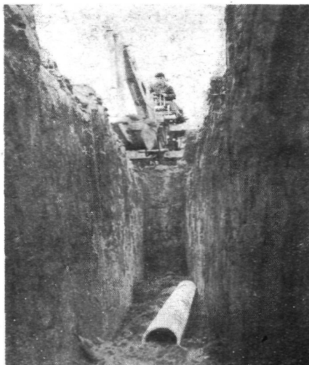
W czynie społecznym i przy pomocy mechanicznego sprzętu gospodarni rolnicy wsi Mielezki w powiecie łódzkim rozbudowują swoją sieć wodociągową. Do wybudowanych w poprzednich latach 900 m, obecnie dodają 1500 m
