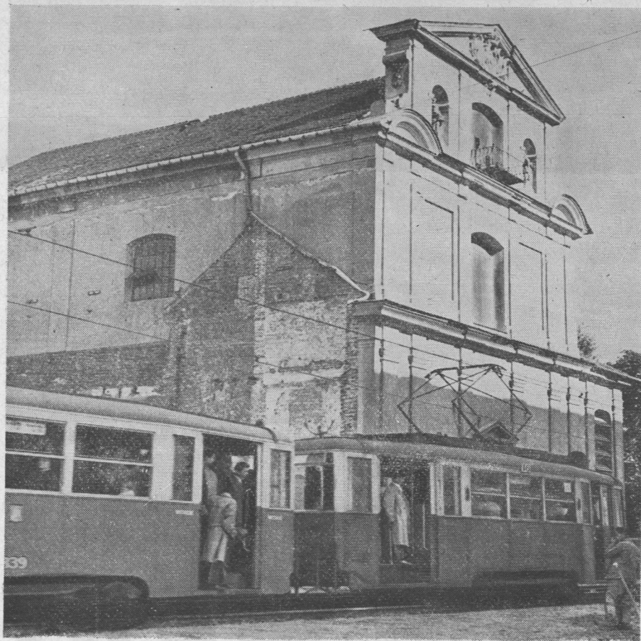
Już wkrótce rozpocznie się przeprowadzka. Wówczas majestatycznie ruszy wazący 6 tysięcy ton kościół. Ustanie ruch kołowy, aby uniknąć drgań gruntu
