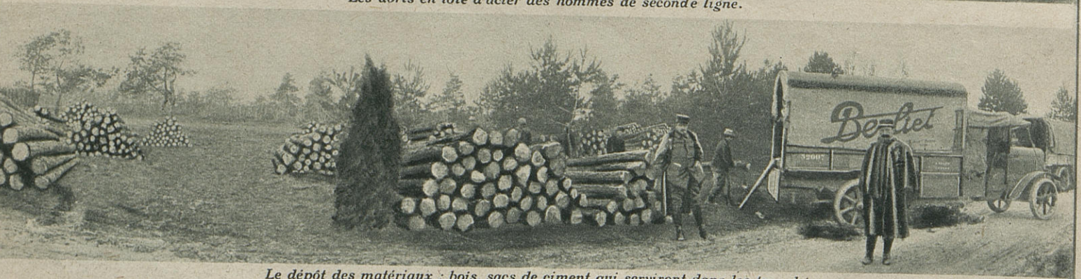
Le dépôt des matériaux : bois, sacs de ciment qui serviront dans les tranchées.
