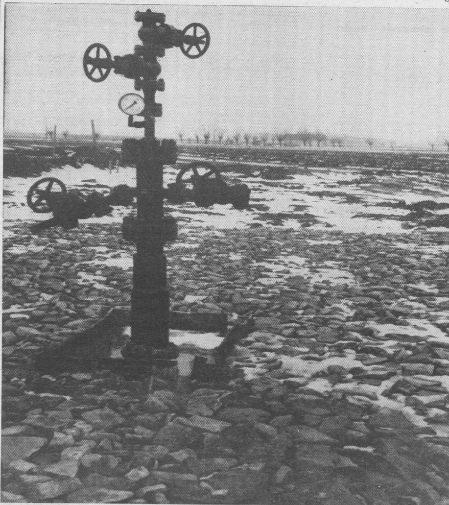
W języku naftarzy taki przyrząd nazywa się choinką. Tutaj podłączony zostanie gazociąg, którym popłynie gaz do potrzeb przemysłowych i użytku domowego.
