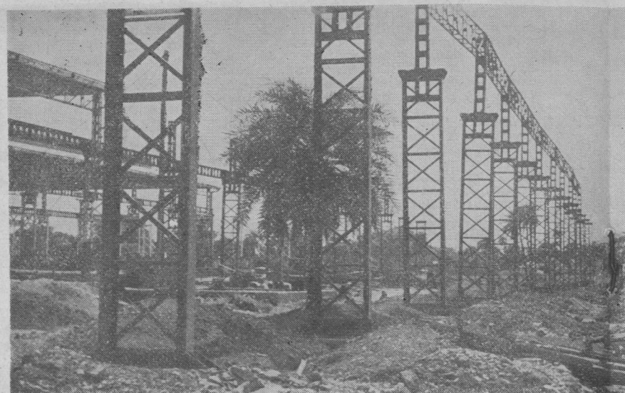
Wśród indyjskich palm polscy inżynierowie zbudowali fabrykę konstrukcji stalowych. O tym, że India jest zadowolona, świadczą dalsze zamówienia
