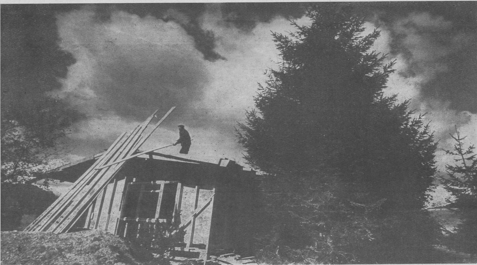
Mało tu pomocników, a robotników trudno znaleźć. Trzeba samemu wszystko ustawić. Budulec pod ręką. Dobrze mieć własny dom
