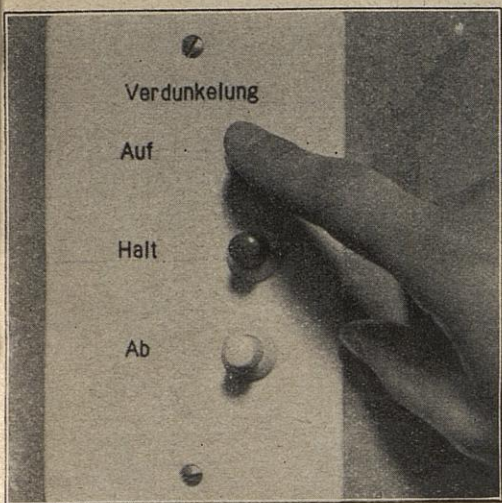
Ein Druck auf den Knopf, der Raum ist verdunkelt. Alle größeren Räume besitzen automatisch arbeitende Verdunkelungsanlagen.
