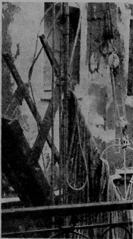
(Sur le chantier Francis Bouygues de Créteil un échafaudage à plateau s'écroule : 1 mort)
