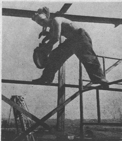
Gdzieś spod nieba odzywa się głos pana Sobczaka. Pracuje przy montażu wieży manipulacyjnej
