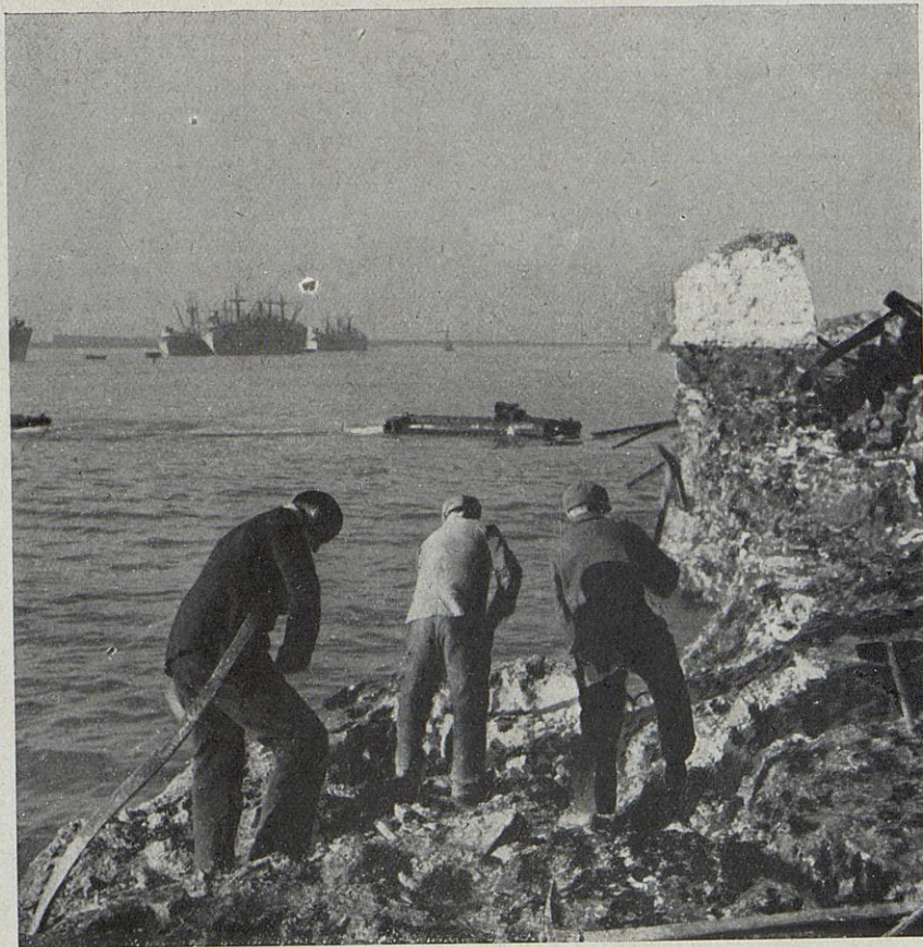
... Et les pioches et les pelles qui remuent et déblaient les ruines chantent que Le Havre qui n'a pas voulu mourir retrouvera bientôt sa vitalité de jadis.
