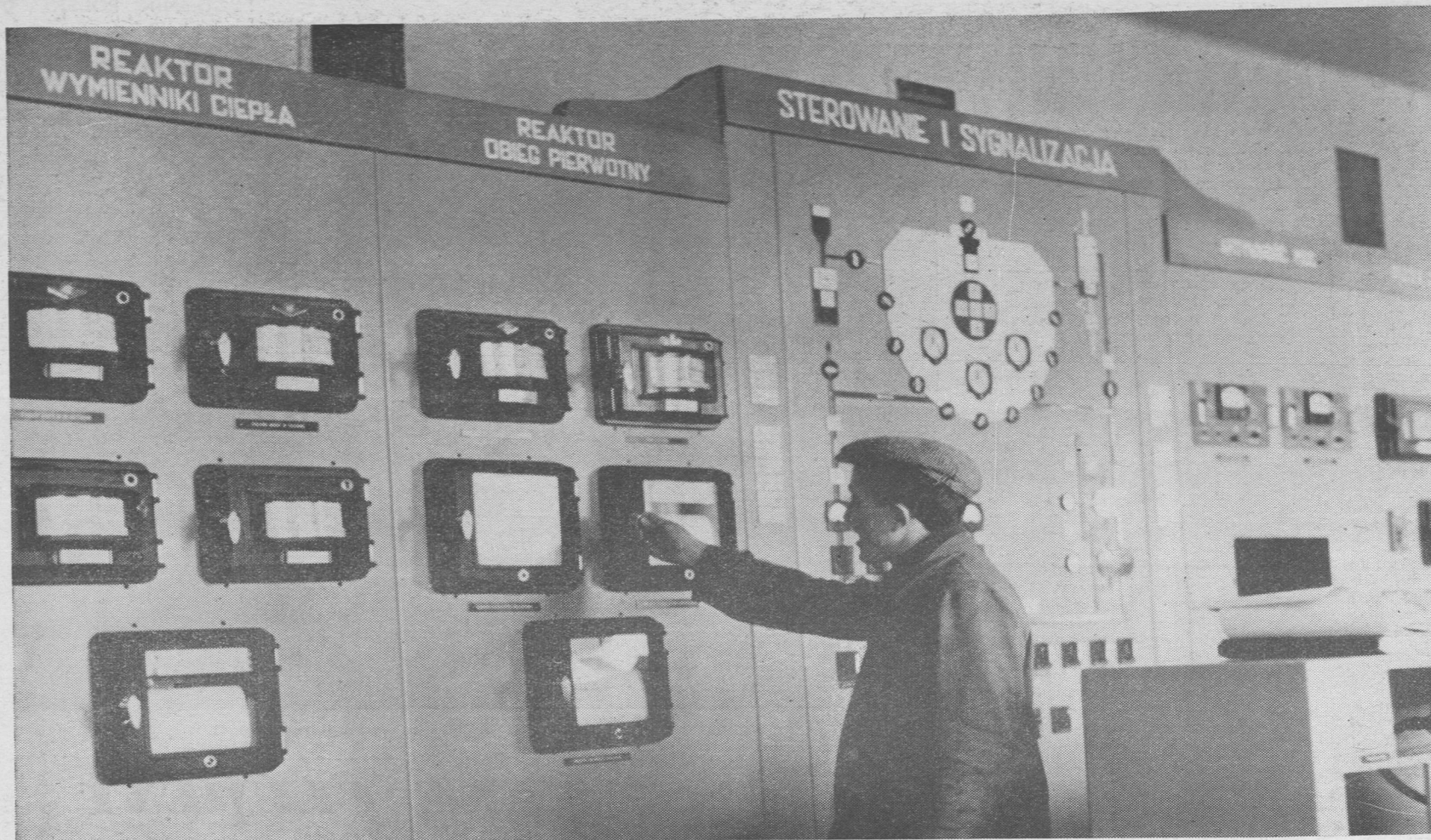
Główna sterownia. Trzydzieści kilometrów różnego rodzaju instalacji zamontowanych w budynku reaktora, tu właśnie posiada swój „mózg”. Stąd kieruje się pracą urządzeń reaktora, tu otrzymuje się informacje, czy aparaty wykonują zlecenia człowieka
